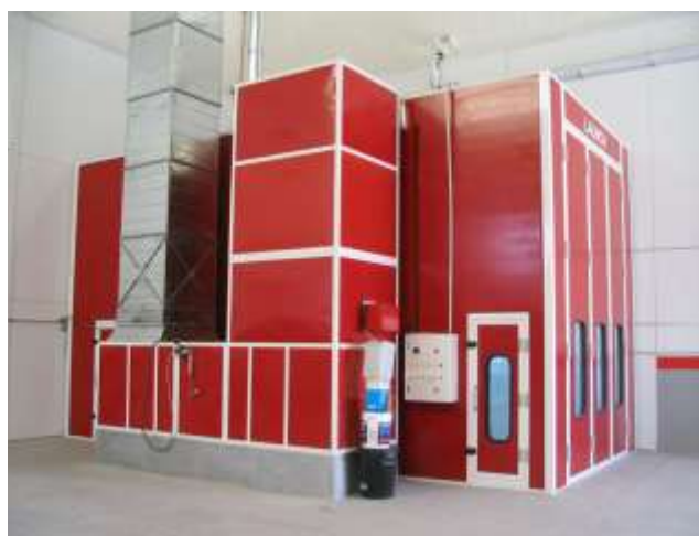
Ejemplo de cabina de pintura con foco de extracción de gases, al frente, y foco del equipo de combustión, al fondo. Creative Commons" de dominio público (CCO 1.0 DEED).
