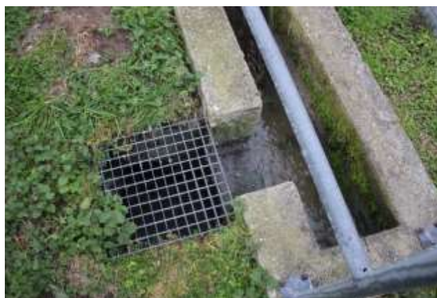
Entrada de vertido a instalación. Existencia de un BY-PASS, sin pretratamiento previo. Consejería de Transición Ecológica, Industria y Desarrollo Económico, Gobierno del Principado de Asturias.
