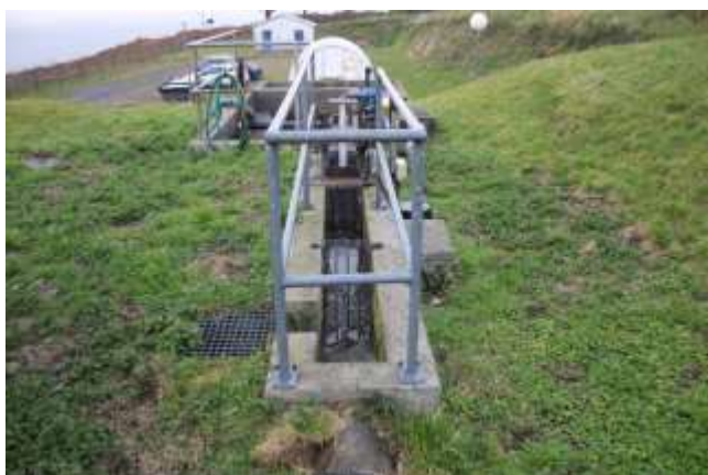
Entrada de vertido a instalación. Inexistencia de Caudalímetro para medición. Consejería de Transición Ecológica, Industria y Desarrollo Económico, Gobierno del Principado de Asturias.
