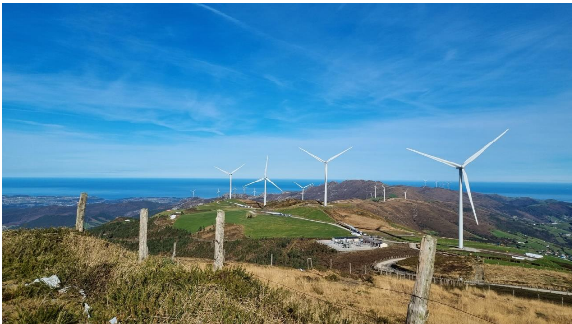
Foto: Parques eólicos de “Panondres” y “Cordel y Vidural”
